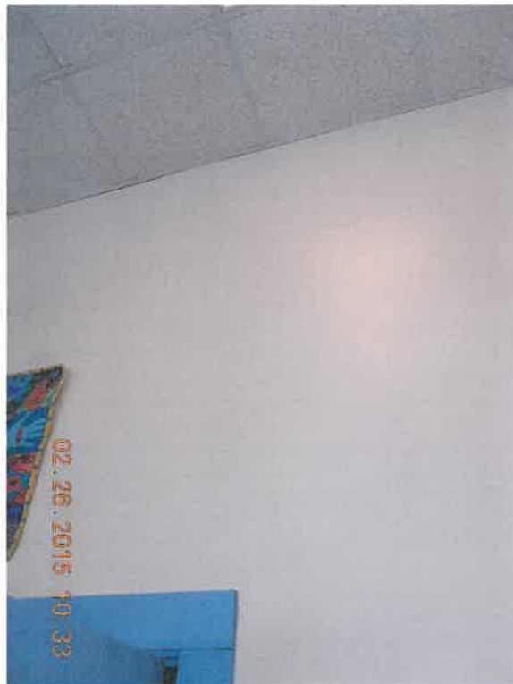
Commons wall crack
